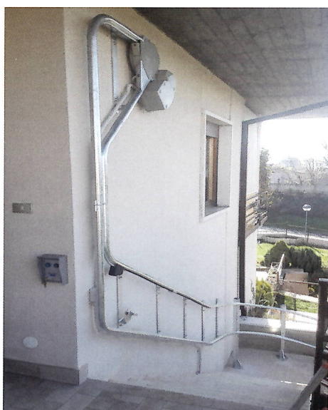
Motore "a collo d'oca" a soffitto
